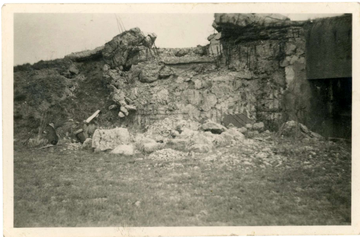
obr 60 - poškozený vojenský bunkr (MP)
